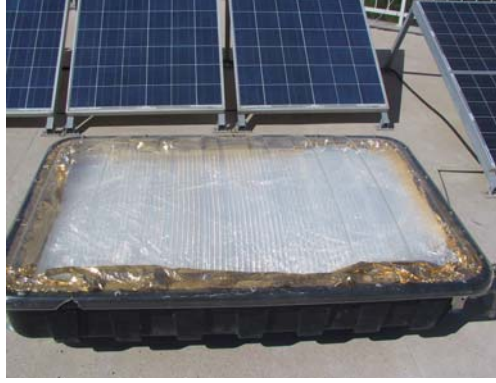
Şekil 4. Güneş Tuzağı, Polimerik Sıcak Su Üretim Sistemi.
