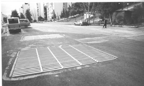
Dere yatağı kapatılmış ve yol yapılmış. Dere kaynağından çok fazla miktarda rütuhat geliyor, yatağı tıkıyor. Yağmır gelene rütuhatı tutabilmek için kum tutucu havuzlar yapıldı. Resimdeki büyük zgaralar aynı zamanda kum tutucu kapaklardır. Her yağmurdaki kapaklar açılarak tonlarca malzeme temizleniyor.
