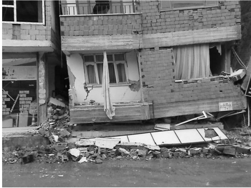
Şekil 11 Van Erciş'te çarpışma etkisi ve yumuşak kat sebebiyle ağır hasar ve göçen binalar.
