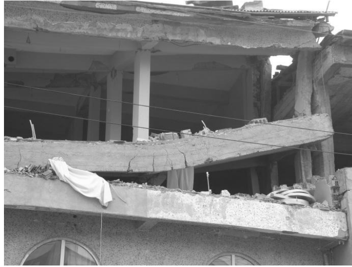
Şekil 7 Van/Erciş'te çarpma (çekiçleme) etkisi sebebiyle ağır hasarlı yapı.
