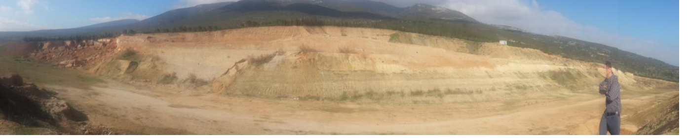
Şekil 7. Kayaocağının620m.güneyinde yeralan ve Pliyo-Kuvaternergölsel çökeller ile üzerinde yeralan alüvyon yelpazesinde açılan Demiryolu Bağlantı Hattı aç-kapa şevlerinde jeoteknik etüt ve/veya uygulama sırasında ki hatalardan kaynaklanan duraysızlık problemleri
