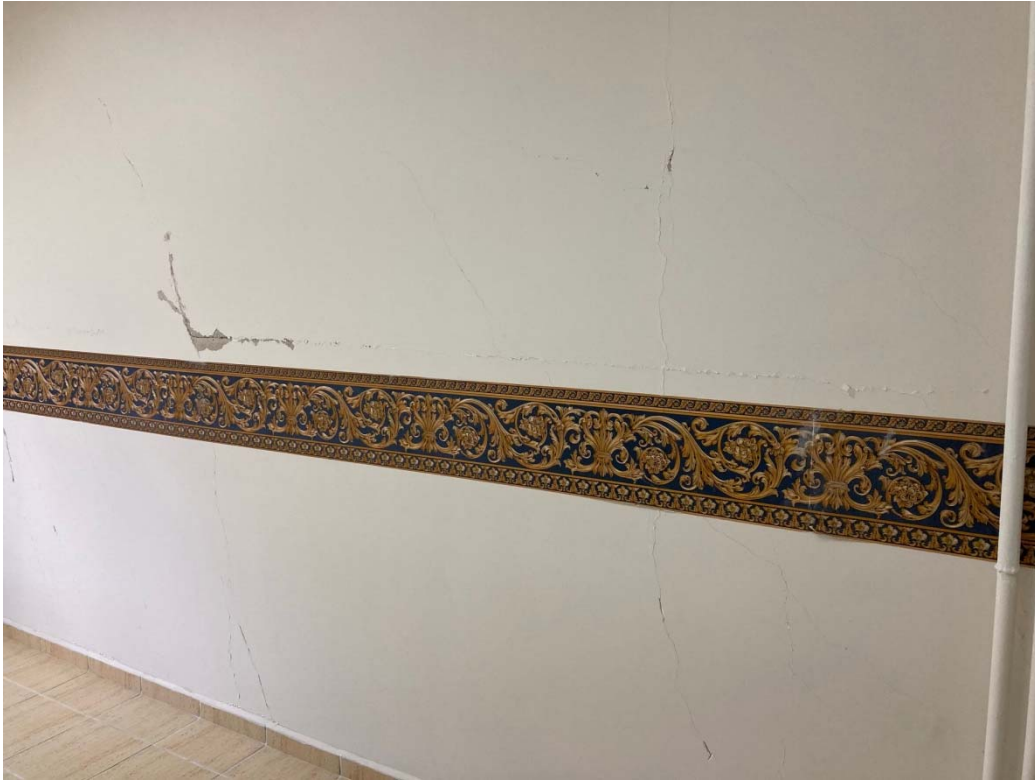
Şekil-15. Perde duvarda soğuk derz boyunca ve çevresinde oluşan hasar
